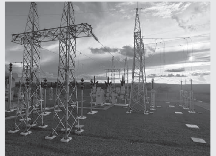
A nova subestação Minas Novas 2 vai entrar em operação nesta semana beneficiando 70 mil mineiros do Vale do Jequitinhonha
