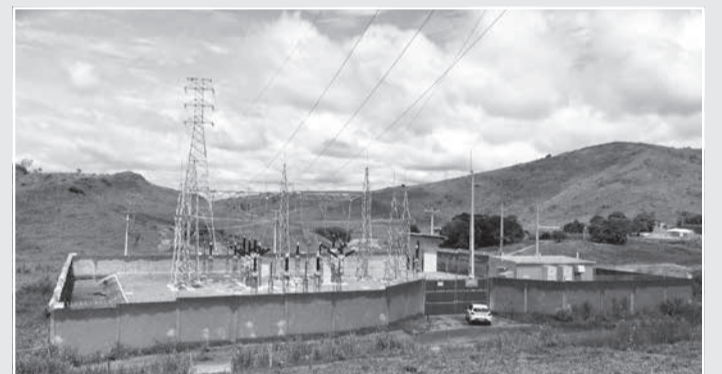
Novas subestações, construídas no Vale do Rio Doce, oferecem infraestrutura energética para o crescimento da região
