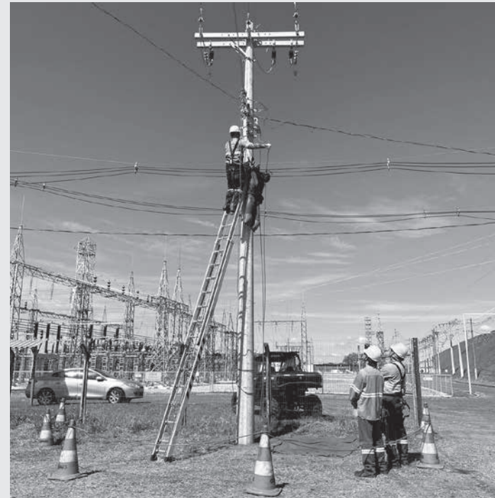
A Cemig orienta que os serviços de obras civis devem sempre ser feitos com o máximo cuidado e segurança, observando a distância de segurança da rede elétrica e o uso de EPIs
