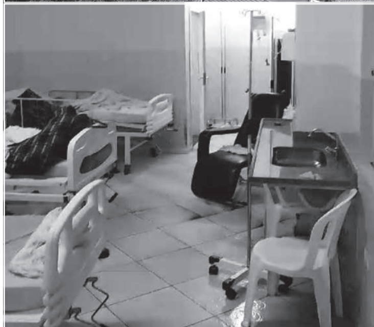
Água entrou no Hospital Raimundo Gobira, pelo teto-lâmpadas
