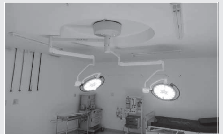
Entre os projetos aprovados na Chamada Pública e beneficiados com o investimento do Programa de Eficiência Energética da Cemig, destacam-se a instalação de usinas solares fotovoltaicas e modernização de equipamentos em hospitais e a eficiência de iluminação pública em diversos municípios
