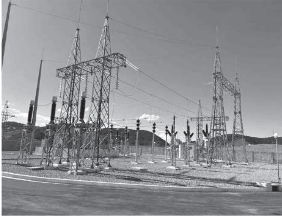
A Subestação Pequeri, localizada na cidade de mesmo nome, na Zona da Mata Mineira, é a 80ª entregue pelo Programa Mais Energia, da Cemig
