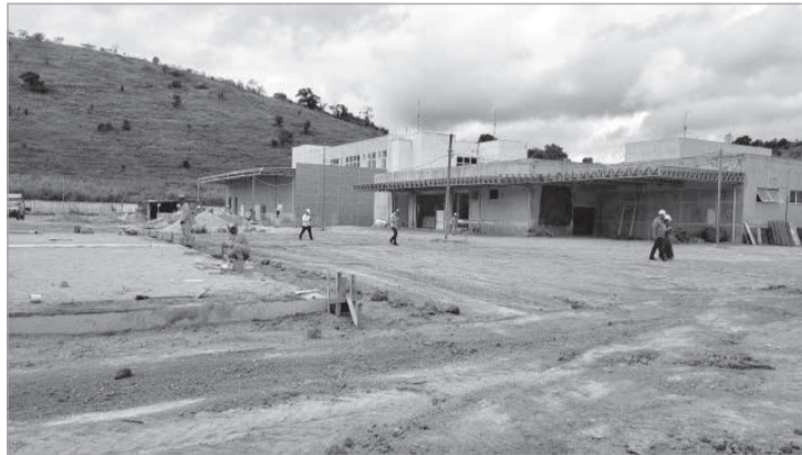
Secretaria de Estado de Saúde / MG e Seinfra vistoriam as obras do Hospital Regional Teófilo Otoni
