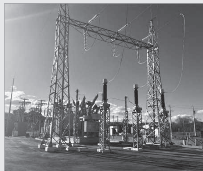
A entrada em operação da subestação Itanhomi 1 representou um investimento de cerca de R$ 50 milhões no sistema elétrico da região e vai beneficiar mais de 90 mil mineiros
