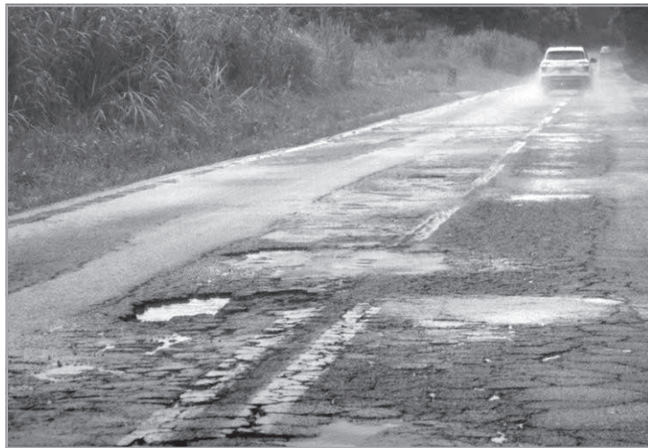
O trecho entre Maripá e Argirita da BR-267 está com situação precária, com buracos na pista (Foto: Felipe Couri)
