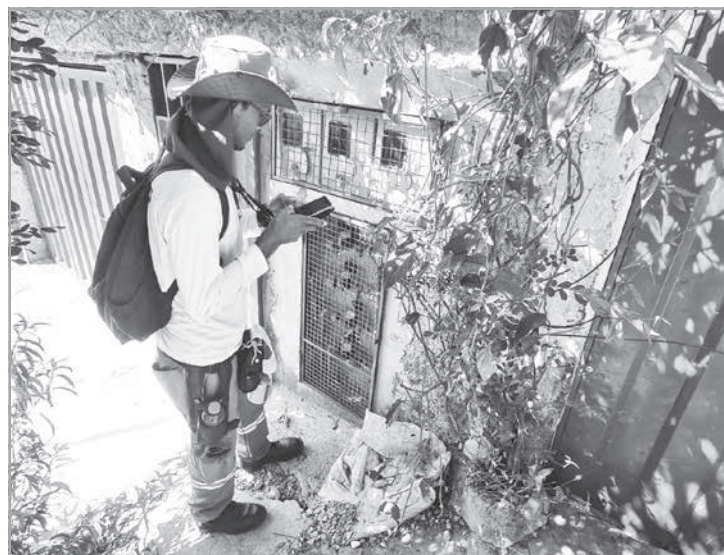
Os profissionais da Cemig não entram no interior da residência para realizar inspeções, manutenções ou leituras de rotina. O acesso normalmente se limita ao local onde está instalado o padrão de entrada e o medidor de energia.
